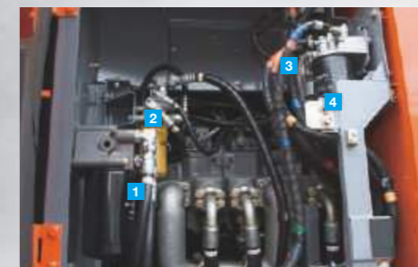
1 エンジンオイルフィルタ 2 パイロットフィルタ 3 燃料プレフィルタ 4 燃料メインフィルタ
