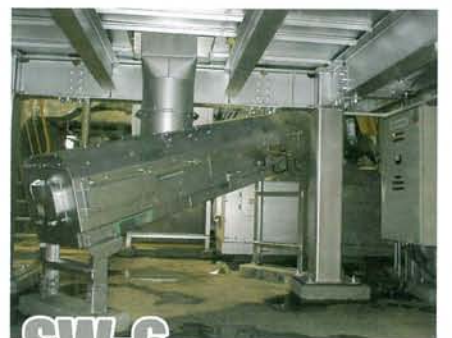
SW-6 スラグ・フラックス搬送 舟底型 コンベヤ
