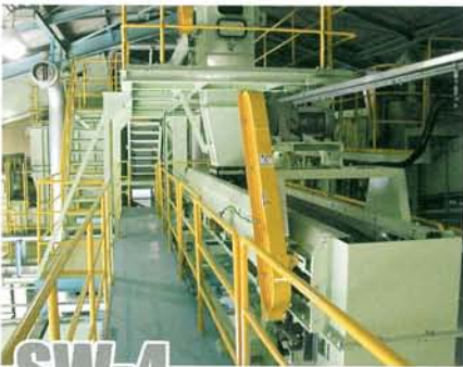
SW-4 RPF製造設備 舟底型 紙搬送コンベヤ
