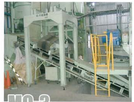
MC-3 廃木材処理プラント 舟底型 (鉄粉除去ライン)
